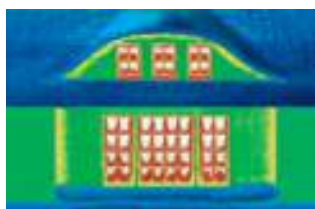
FØR: Det røde i termograferingen viser varmeudslippet.
